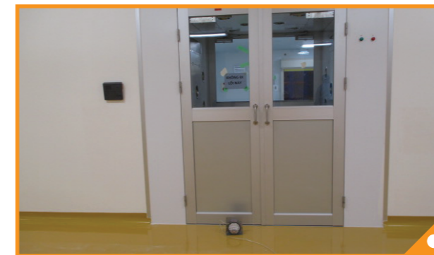
Kiểm tra áp suất phòng ROOM PRESSURE CHECK
